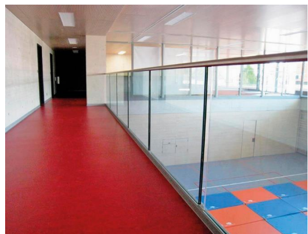
Abbildung 42 Absturzsicherung aus Verbund-Sicherheitsglas (VSG)
